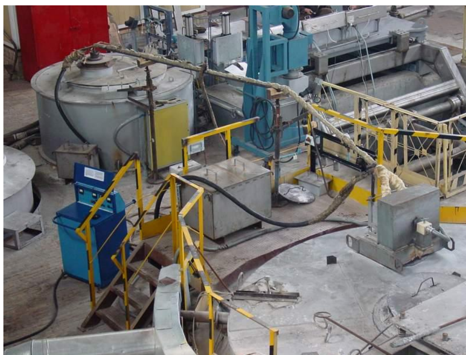
Рис.4.76. Двухкамерный погружной электровихревой насос установлен на печи солевого разогрева (слева на переднем плане) подает жидкий магний в раздаточную печь (правый верхний угол ) машины полунепрерывного литья крупногабаритных магниевых слитков на ОАО «АВИСМА» (верх задний план).
