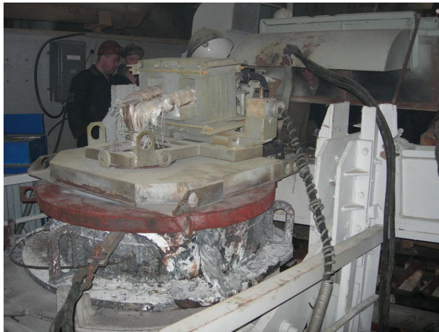
Рис.4.21. Насос наружного расположения Пуш-пул установлен на тигле перед литейным конвейером.
